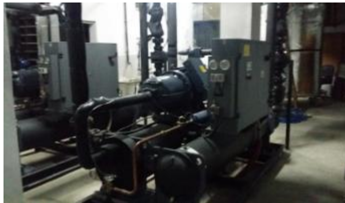
Fig 15. chillerat për prodhimin e ujit të ftohet
